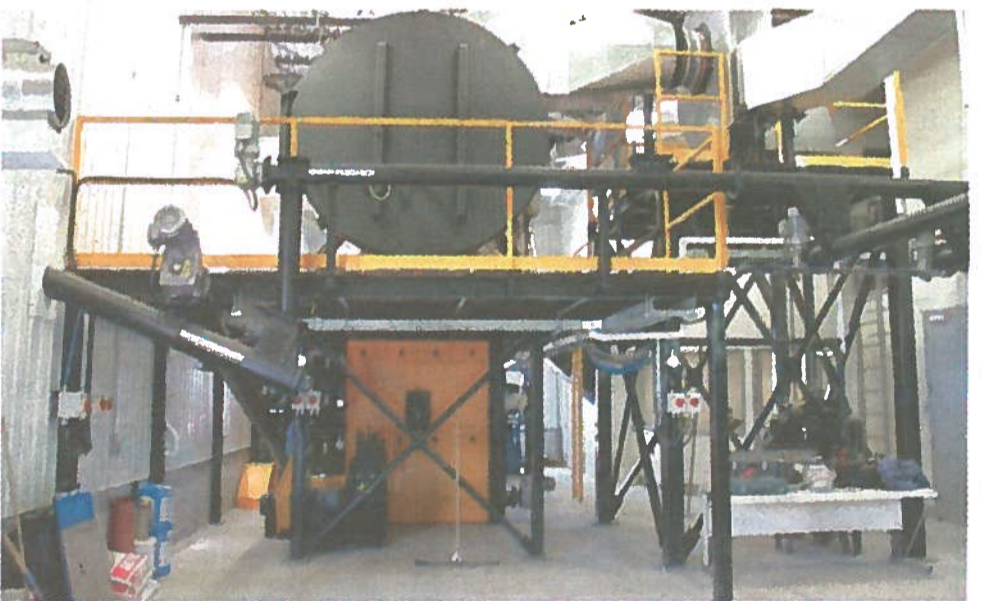
Le système de chauffage à la biomasse à l'Hôpital de Montmagny a nécessité des investissements de 2,8 millions $.
